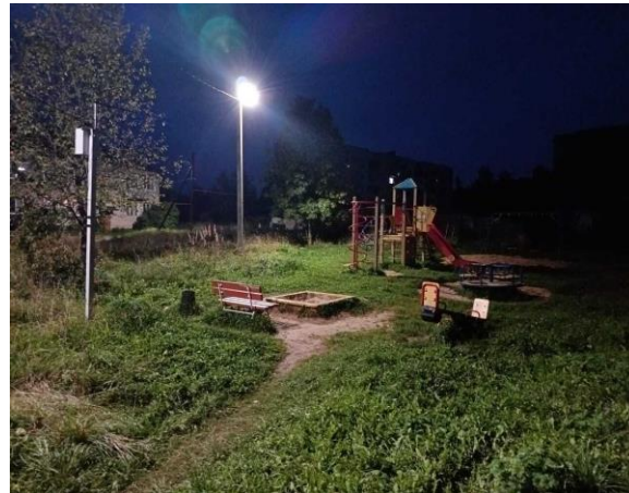
Устройство уличного освещения по адресу: г. Наволоки, п. Лесное у д.9
